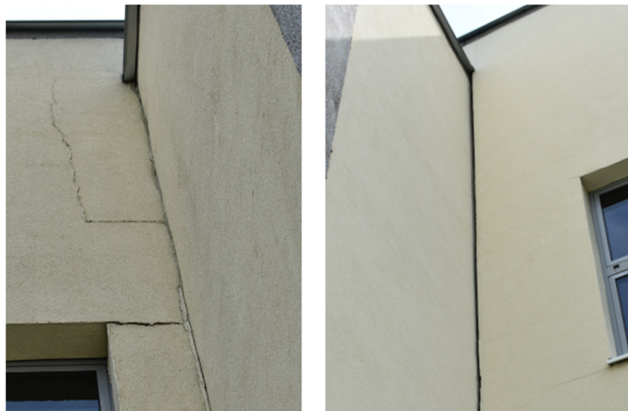
Rys. 4. Strefa dylatacji łącznika (po lewej od strony wschodniej, po prawej od strony zachodniej)
