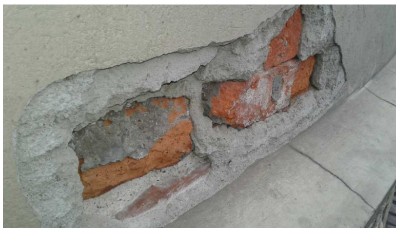
Rys. 3. Odspojenie tynku, fot. autor, październik 2016
