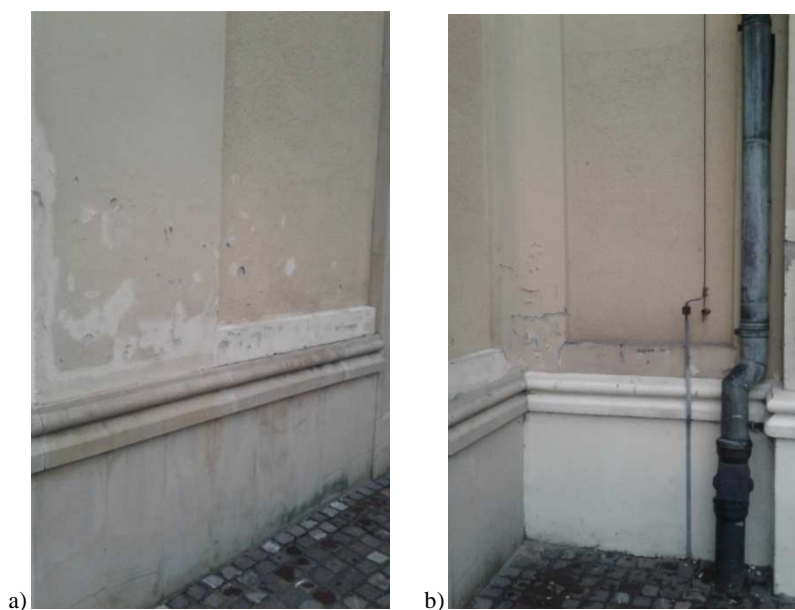
Rys. 2. Degradacja elewacji, fot. autor, październik 2016
