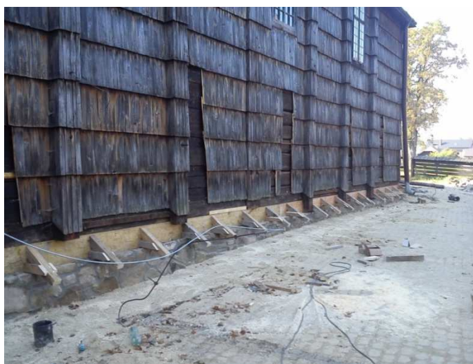
Rys. 3. Wymieniona belka podwalinowa z przemurowaną podmurówką kamienną oraz konstrukcją pod fartuch ochronny, strona północna, 2012, fot. Ł. Gołda
