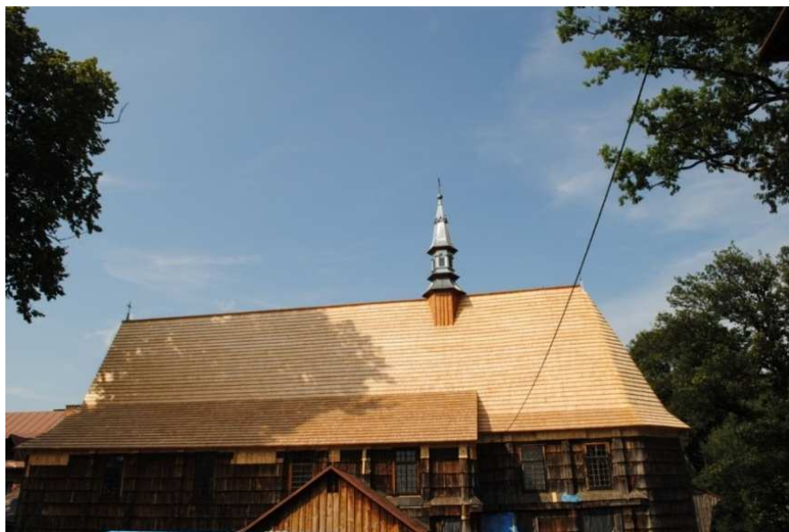
Rys. 7. Widok nowego pokrycia gontowego więźby dachowej z oblachowaniem sygnaturki, 2014, fot. Ł. Gołda
