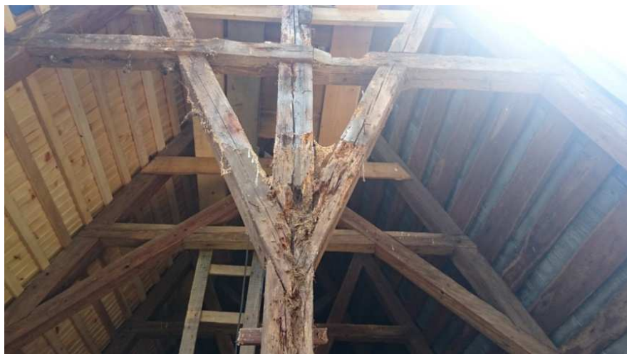
Rys. 5. Widok zniszczonego więzara dachowego ściany szczytowej, strona zachodnia, 2014, fot. Ł. Gołda
