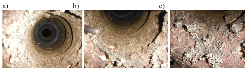
Rys. 3. Widok wnętrza komory PC1 pokrytej żużlem Fig. 3. View of the interior chamber PC1 covered with slag
