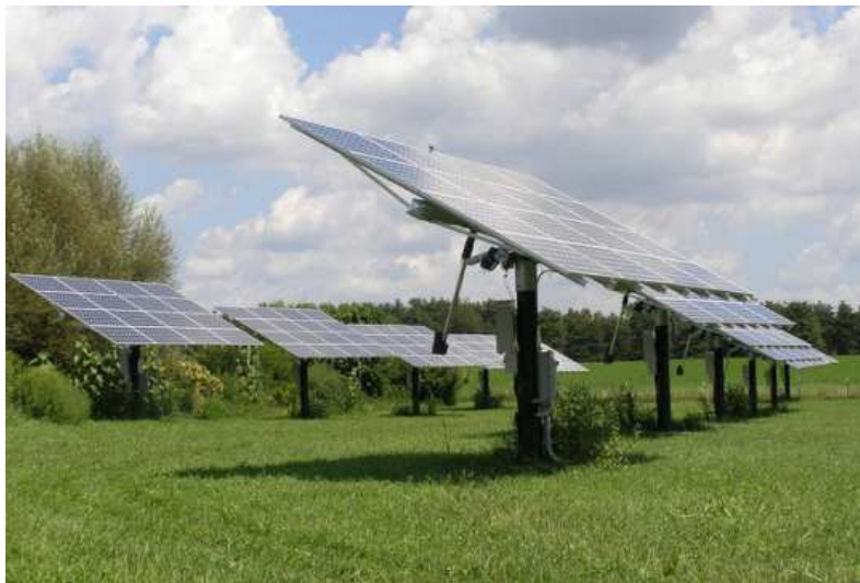
Rys. 7. Konstrukcje tracker'a z panelami słonecznymi [34]
