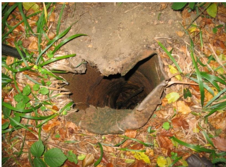
Rys. 2. Miejsce potencjalnego poważnego wypadku. Zlikwidowany otwór wiertniczy znajduje się około 10 m od Alei Wincentego Pola i 300 m od źródła „Belkotki”; na powierzchni gleby widoczny fragment rury okładzinowej, pozostawionej prawdopodobnie z przyczyn technicznych i ze względów ekonomicznych. Gmina Iwonicz-Zdrój, woj. podkarpackie (Lipińska E.J. 2013)
