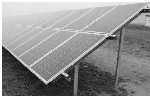
Rys. 4. Ustawienie modułów na farmie fotowoltaicznej w Wierzchosławicach
