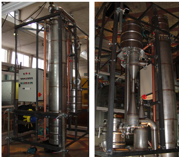
Rys. 3. Widok elementów instalacji oczyszczania gazu
