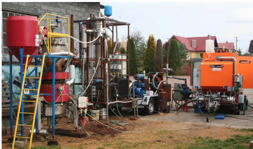
Rys. 3. Widok układu zgazowującego wraz z agregatem prądotwórczym
