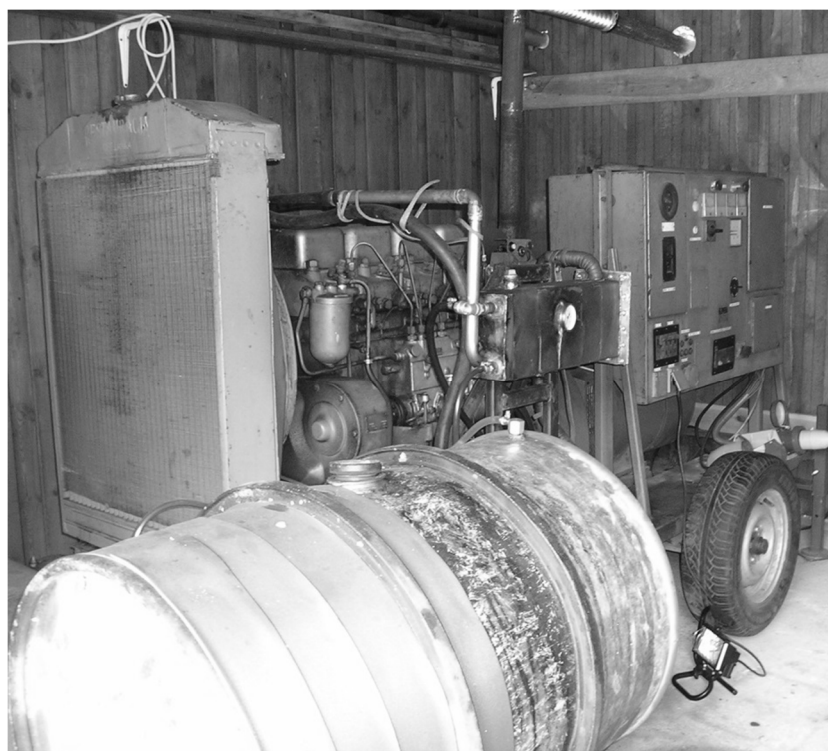
Rys. 1. Agregat prądowórczy z widocznym pierwszym stopniem wymiennika ciepła
