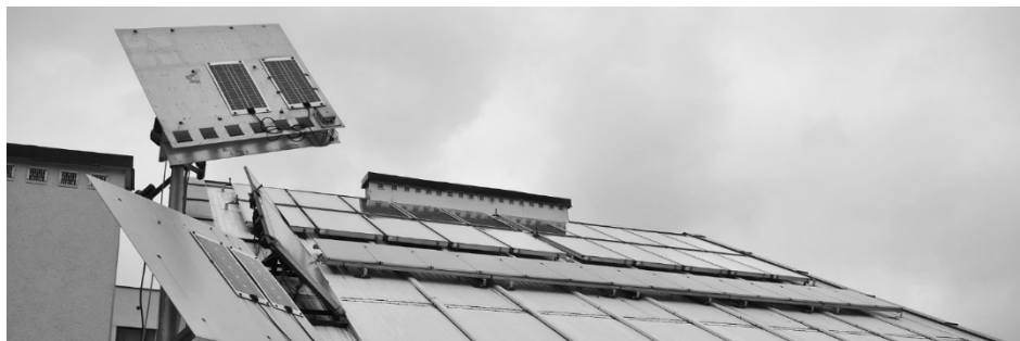
Rys. 2. System słoneczny zainstalowany na dachu Auli Wydziału Zarządzania i Podstaw Techniki Politechniki Lubelskiej.
