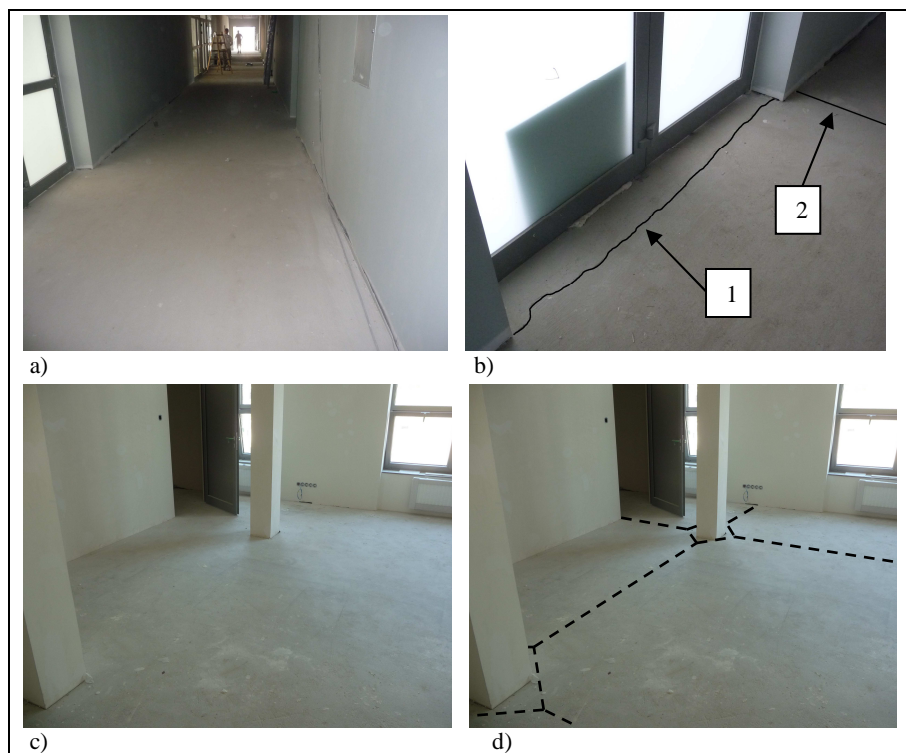
Rys. 2. Zdjęcia z realizacji podłogi pływającej pod posadzkę z wykładziny PVC: a) widok korytarza, b) zaznaczone pęknięcie podkładu wzdłuż otworu drzwiowego (1) oraz przeciwskurczowa dylatacja pozorna (2), c) zrealizowany podkład cementowy bez wymaganych dylatacji, d) zarys dylatacji typu „karo” oraz dylatacji przeciwskurczowych, które powinny być zostać wykonane
