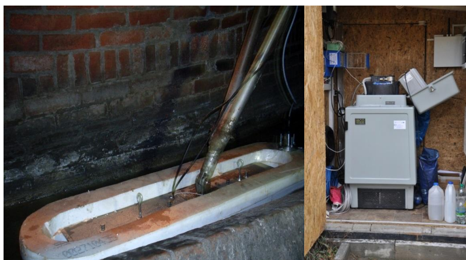
Rys. 1. Widok stanowiska pomiarowego: a) pływak z zamontowanymi sondami, b) szafka pomiarowa usytuowana nad przelewem burzowym z pobierakiem i panelem do odczytu pomiarów
